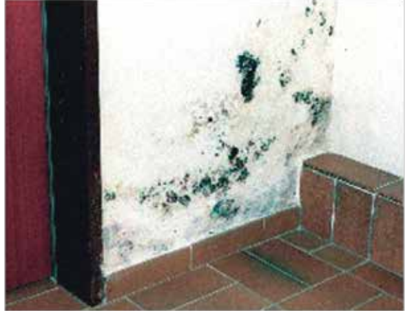
Duvar üzerinde oluşan küflenmeler
